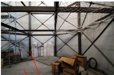
鋼製支柱 (ブレース、C形鋼等含む) [基準4] コンクリート [基準4]
